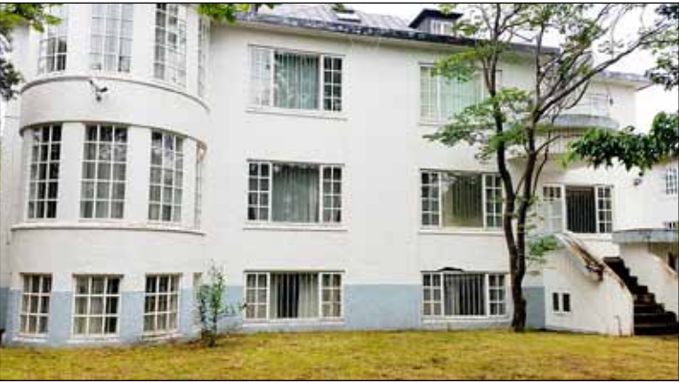
Bakhlið húss Kínverska sendiráðsins við Víðimel 29. Gardínur og strimlar hanga fyrir gluggum. Garðurinn er í órækt og skemmdir sjást víða.
