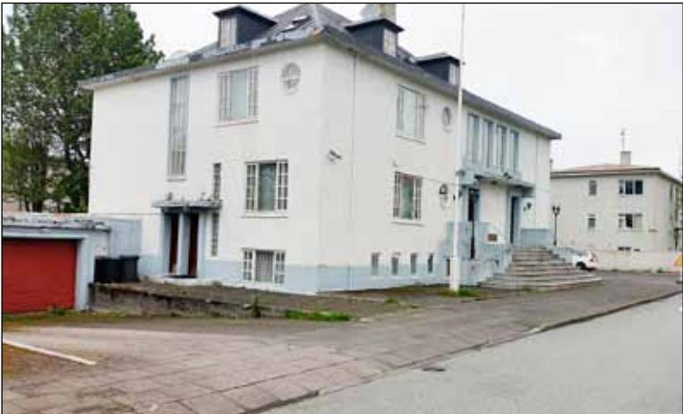
Glæsihús á eftirsóttum stað í Vesturbænum hefur ekki verið í notkun frá árinu 2012 og grotnað niður. Nú virðist húsið óíbúðarhæft með öllu og mikið verk mun vera að koma því í nýtanlegt ástand.
